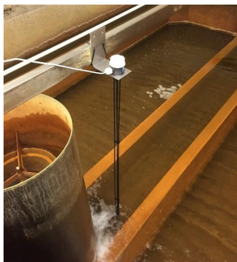
Foto: Elektroden placeret i skyllerenden under testperioden.
