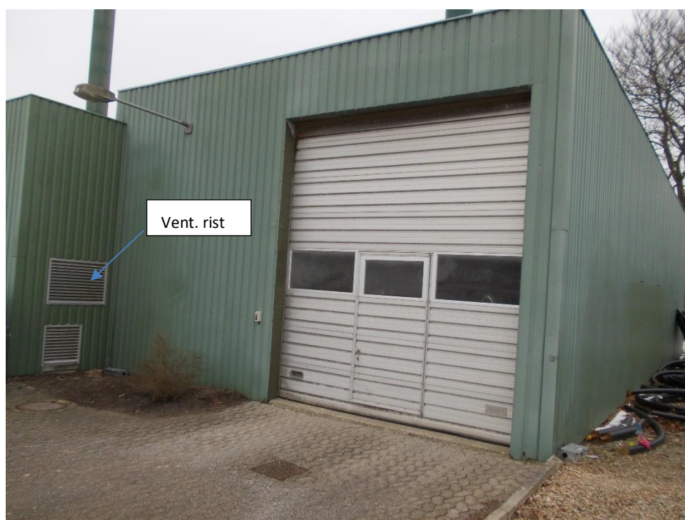
Figur 1, foto af ventilationsrist samt sydvendt port til træpillehallen.
